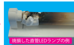
焼損した直管LEDランプの例
